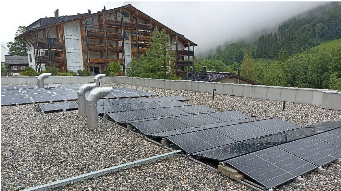
Abbildung 3: Ansicht der 30 \text{ kW}_{\text{peak}} PV-Anlage am Flachdach des Mehrzweckhauses
